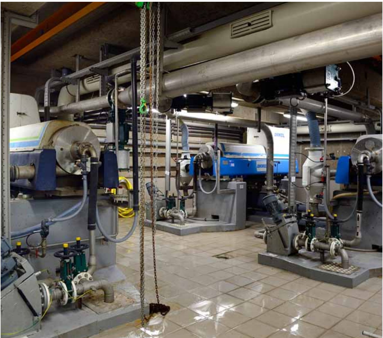
Centrifugeuses à la station de traitement des eaux usées à Fleurieu/Neuville
