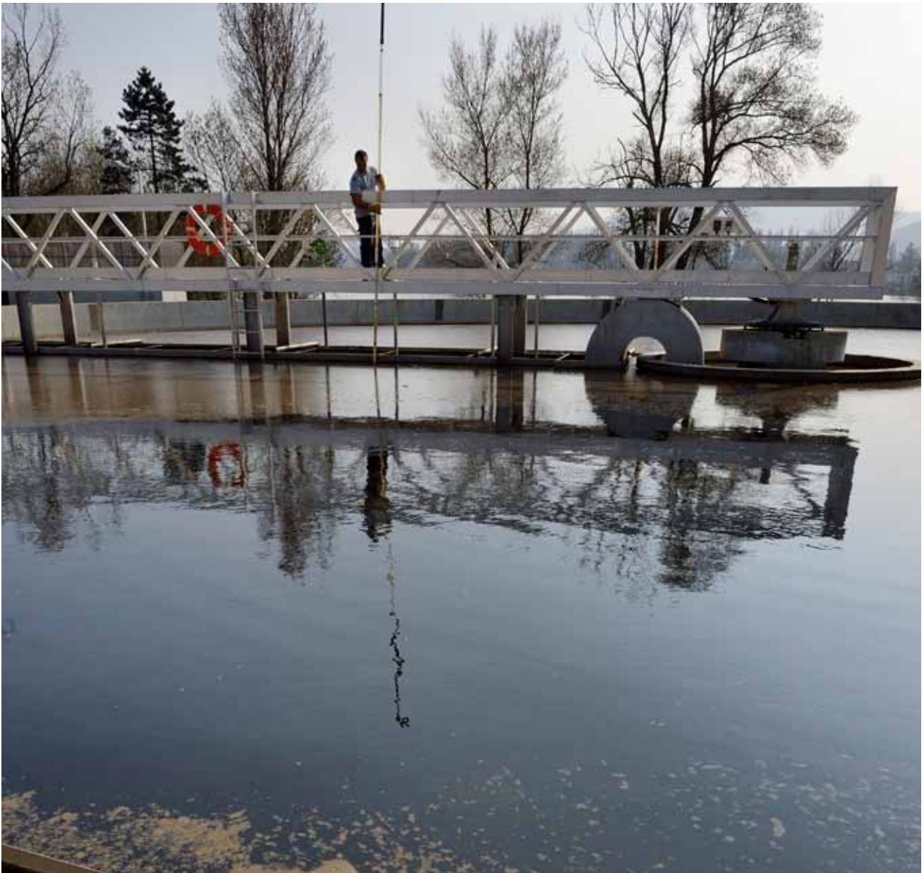
Clarificateurs de la station de traitement des eaux usées à Fleurieu/Neuville
