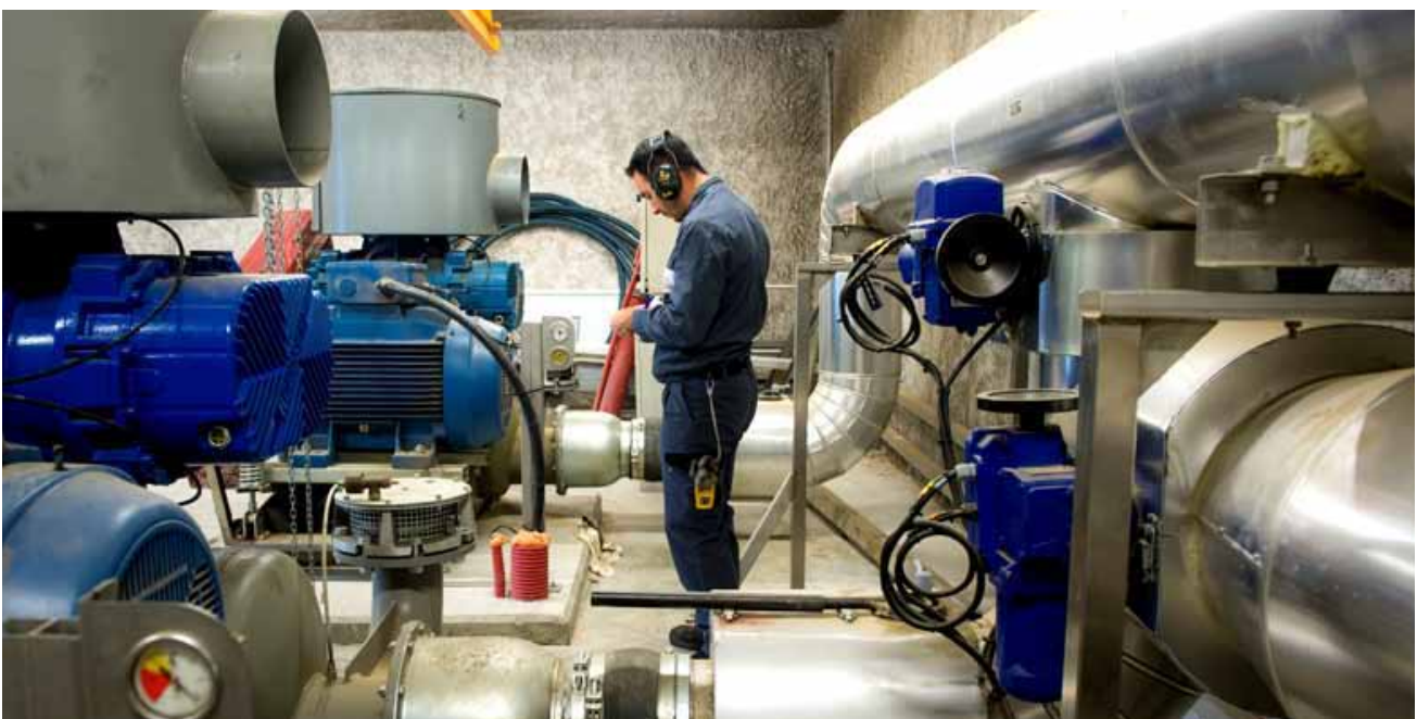
Agent du Grand Lyon dans la station de traitement des eaux usées à Jonage
